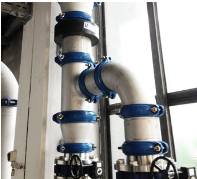
Brunnenwasser mit Strengthin100® | Quelle: Victaulic
