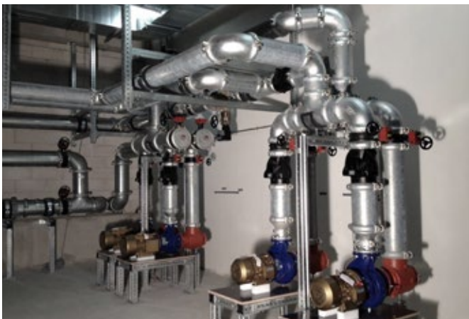
Kältezentrale BMW Werke München | Quelle: Victaulic
