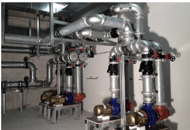
Kältezentrale BMW Werke München | Quelle: Victaulic
