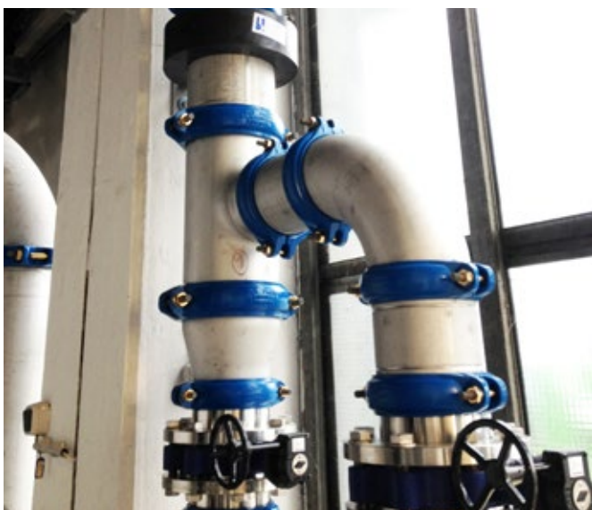
Brunnenwasser mit StrengThin™ 100 | Quelle: Victaulic
