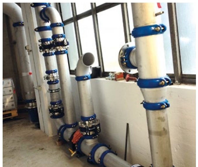
Trinkwasser mit StrengThin™ 100 | Quelle: Victaulic
